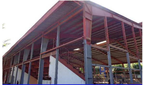
En esta fotografías apreciar las instalaciones del Gimnasio de Combate situación sin proyecto observar vista interna.
