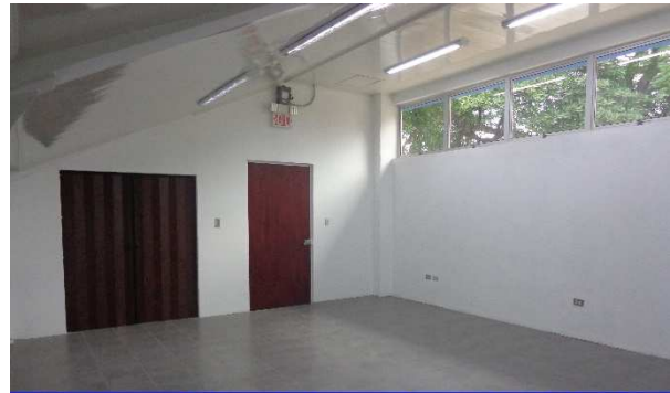
Vista interna de la sala de reuniones - Gradería Este, donde se observa la ejecución etapa de puertas, ventanas, lámparas, piso, cielo raso.
